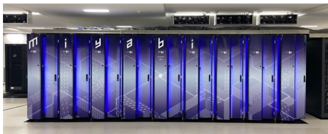
千葉県柏市の東大柏キャンパスに設置されたスパコン「Miyabi」。扉は雅な幾何学模様で飾られている。
