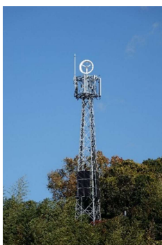
<実証実験中の基地局>
